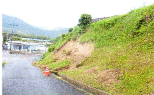
平成26年9月記録的短時間豪雨による土砂崩れ
